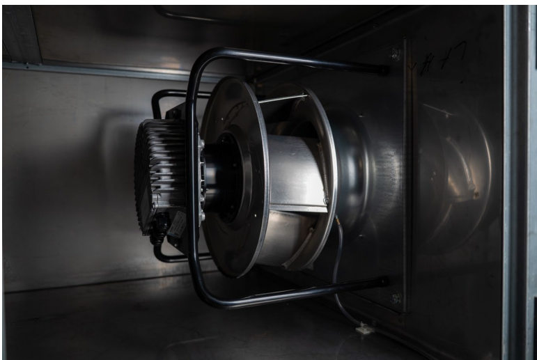
Bild 2: Effiziente RadiPac EC-Ventilatoren von ebm-papst ersetzen die alte AC-Technik.
