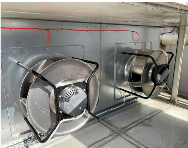
Bild 2: Insgesamt 26 RadiPac wurden als FanGrid jeweils in die Zu- und Abluft-Sektion der vier AHUs eingebaut.
