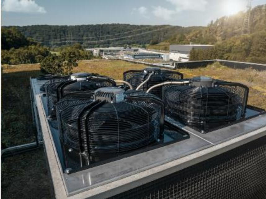
Bild 1: Für das Retrofit bei ebm-papst wurden insgesamt 161 Anlagen ermittelt, bei denen einen Austausch der Ventilatoren in Frage kam, hier ein Bild aus Mulfingen.
