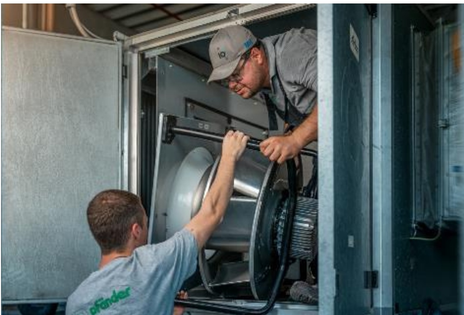
Bild 2: Bei vielen Anlagen wurden EC- durch EC-Ventilatoren der neuesten Generation getauscht.
