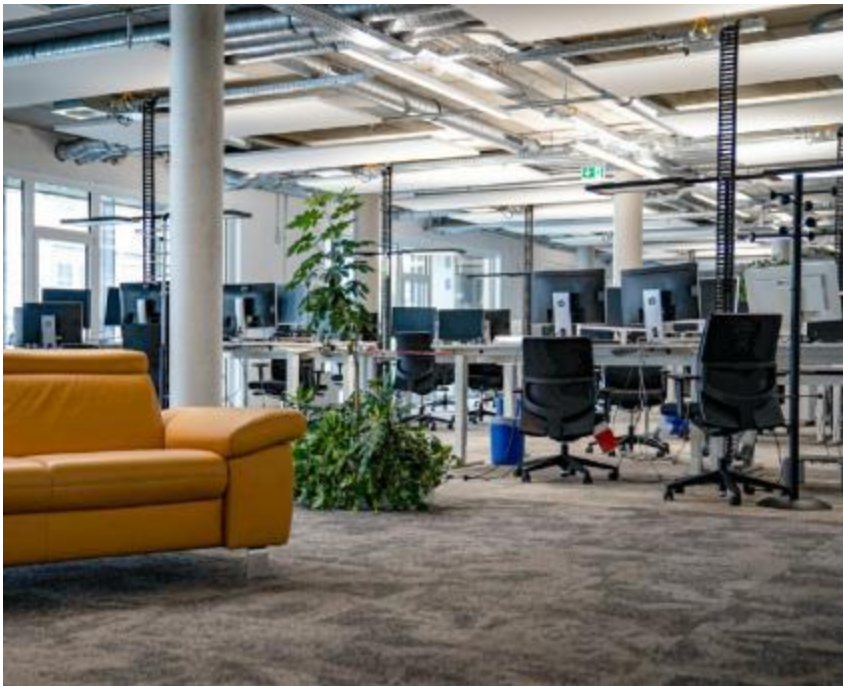
Bild 1: In Ludwigsburg läuft eine der ersten semizentralen Lüftungsanlagen Europas mit rund 300 Ventilatoren von ebm-papst, die moderne Büroräume mit Frischluft versorgen.
