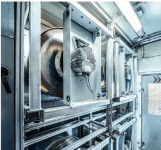
Bild 2: Die neue Lüftungsanlage mit insgesamt 16 RadiPac EC-Ventilatoren sorgt dafür, dass die Milchprodukte bei konstanten fünf Grad Celsius immer frisch bleiben.
