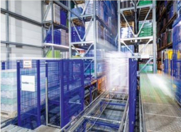
Bild 1: Für das Hochregallager der Elsdorfer Molkerei mit Paletten voll verderblicher Ware ist die Betriebssicherheit der Lüftungsanlage ein zentraler Punkt.
